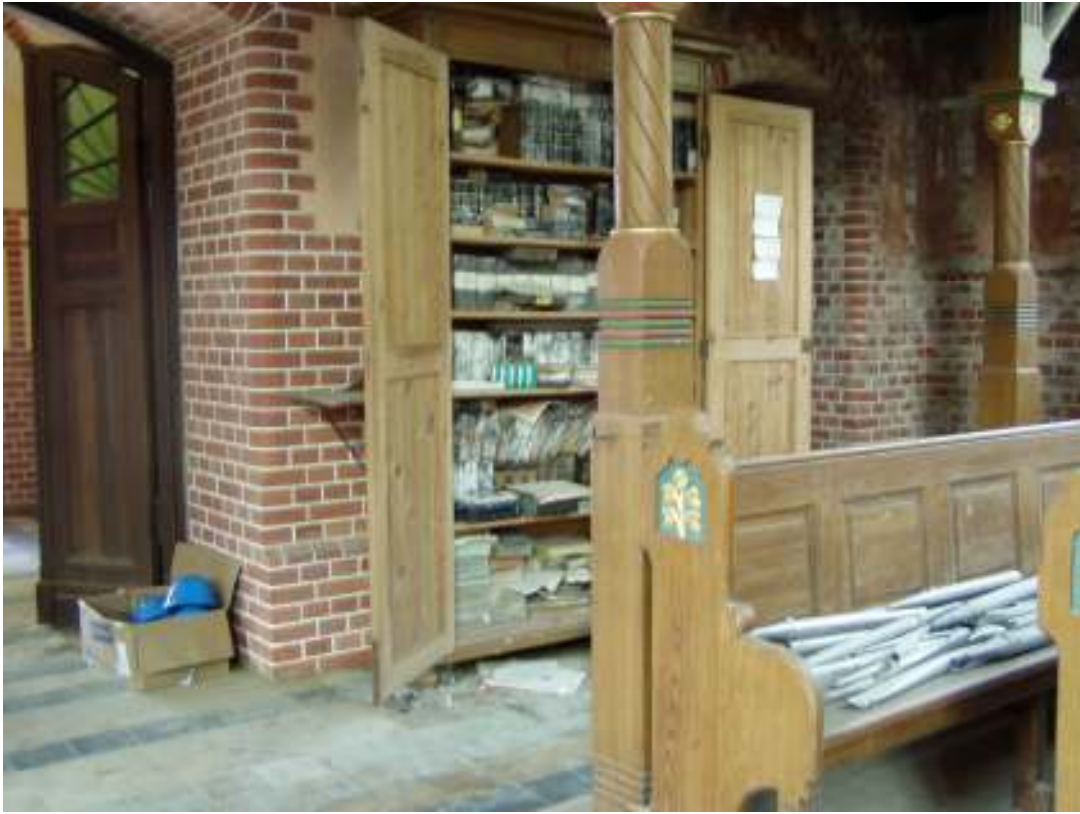
Ett skåp med skadade böcker under orgelläktaren. Observera kartongen med de blå skyddshjälmarna samt orgelpiporna på bänken. Foto: Regionmuseet 2007-06-07.
