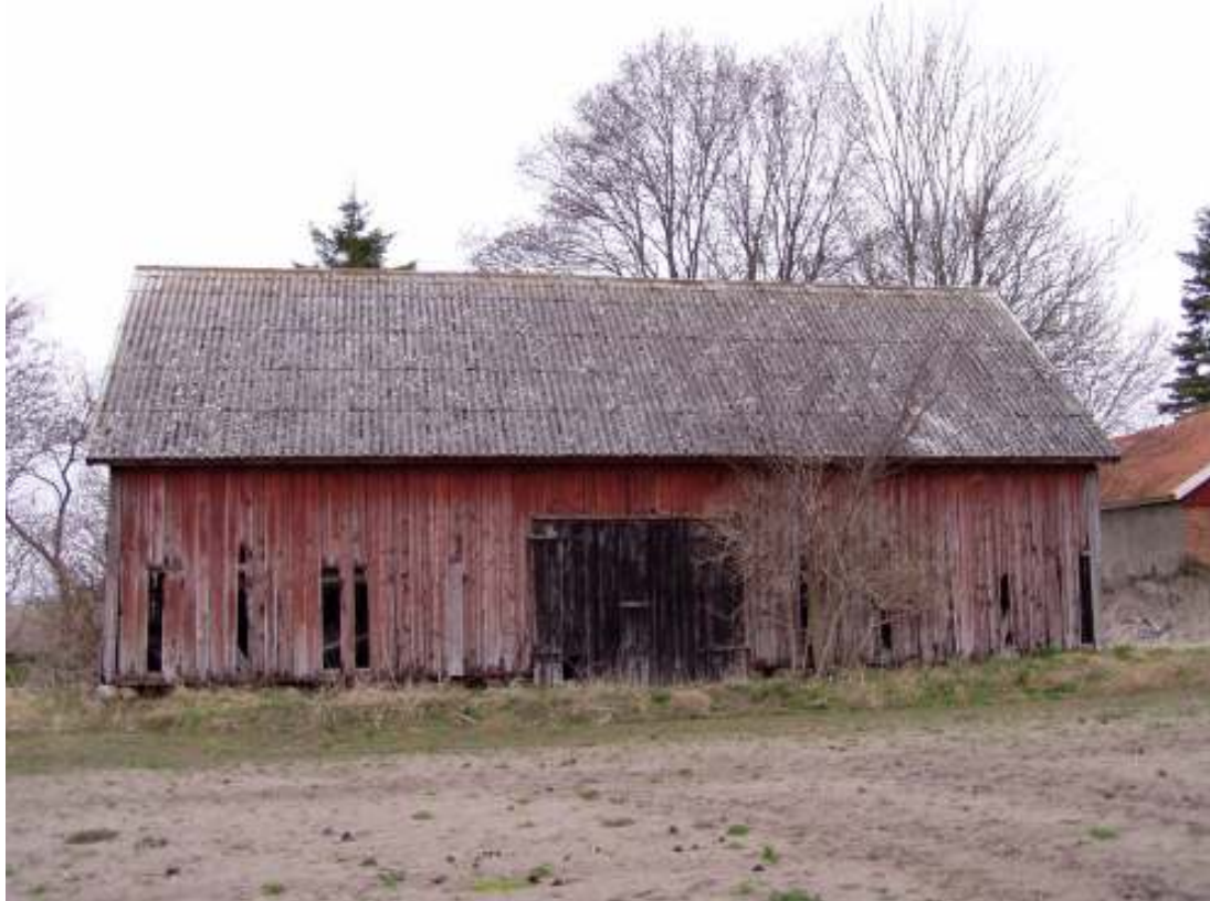
Tobaksladorna är betydelsefulla för både vår kulturhistoria och det liv som finns i landskapet, men de behöver en funktion. Ovan vänster; Eldtorkningslada i Gringelstad. Ovan höger; Hål för slangar till ångpanna som idag ger busrum till fåglar. Nedan; Torklada i Legeved uppförd omkring 1900 med kallmurad grund, regelverk och glesad panel samt stickspånstak.
