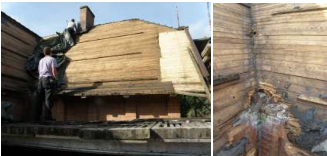
På den vänstra bilden syns de berörda takfallen, den ljusare panelen är en äldre lagning med panel utan profil. På den högra bilden syns rötskador i anslutning till rännviden.
