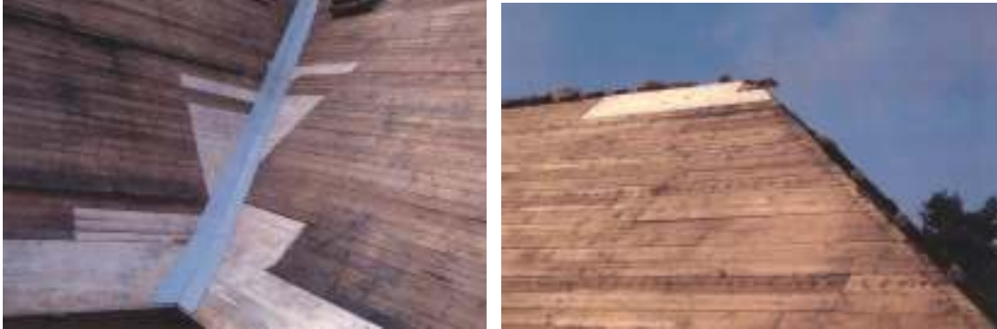
Bilder tagna av hantverkarna som visar lagningar i underbrädningen i anslutning tillnock och rännedal.
