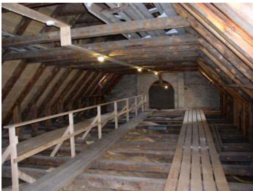
Långhusets vind efter kompletteringar med gångbroar, ledstänger och prydliga installationer för belysning.
