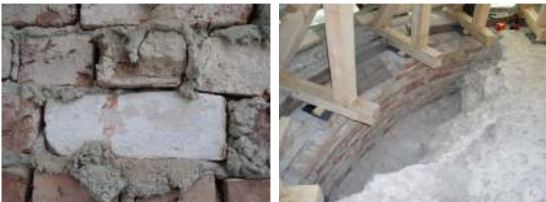
Tv. Detalj av apsidvindens västra tegelmurverk med återamvänd tegelsten täckt av kalkmåleri. Har sannolikt ingått i den medeltida kyrkans interiör. Th. Apsidvindens östra mur med uppbuggning i hjälmvalvet som utfördes när östdörren togs upp.
