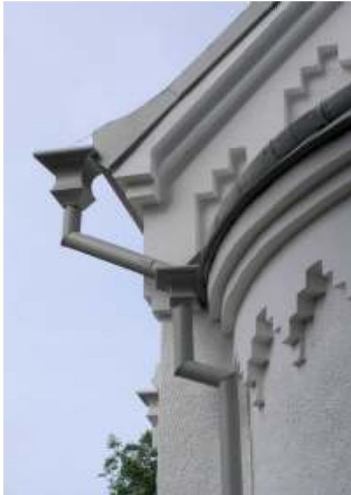
Avvattning i hörnet mellan kor och absid.
