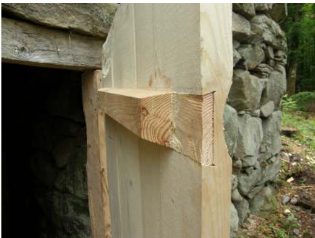
Gradad nare på västra, yttre dörren.
