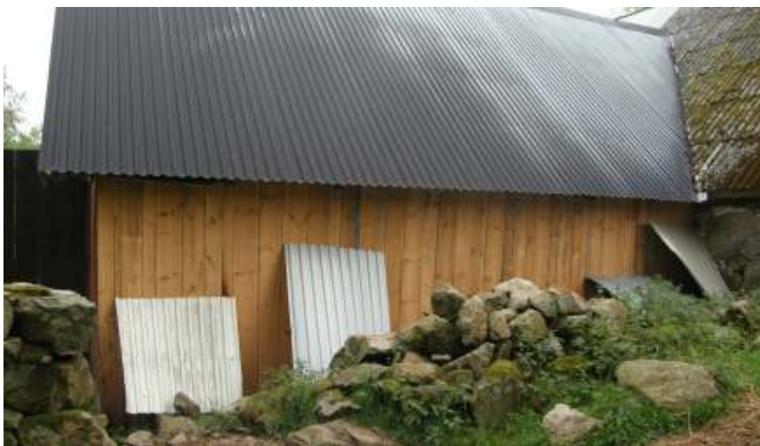
Garaget, södra långsidan. Plåtar ställda som tillfälligt regnskydd.
