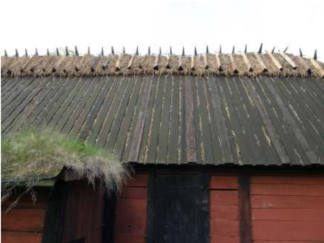
Fig. 17. Det kvarvarande brädtaket på fähusets östra takfall. Då trätaket börjat läcka, lades det temporärt med återanvända brädor.
