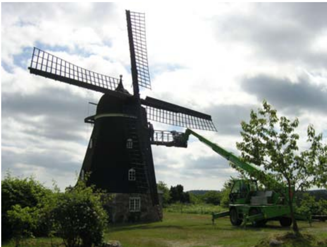
Foto: Ingela Blomén. Den sista av de tre nya vingarna har lyfts upp och förankras med klamrar.
