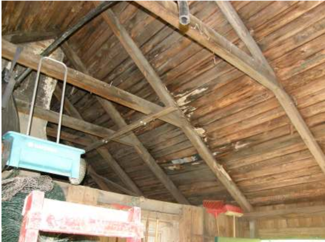
Fig. 16. Innan arbetet. Svampangrepp på den mittre sparren.
