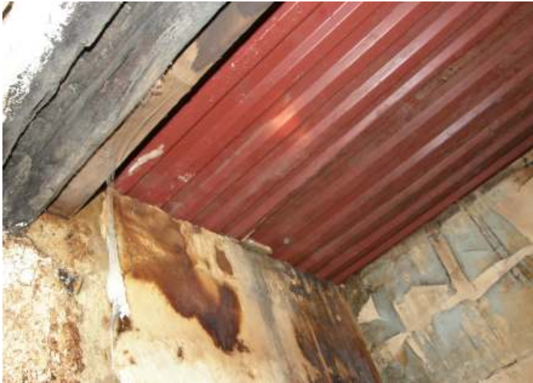
Fig. 13. Igensättningen inne i spiskåpan.
