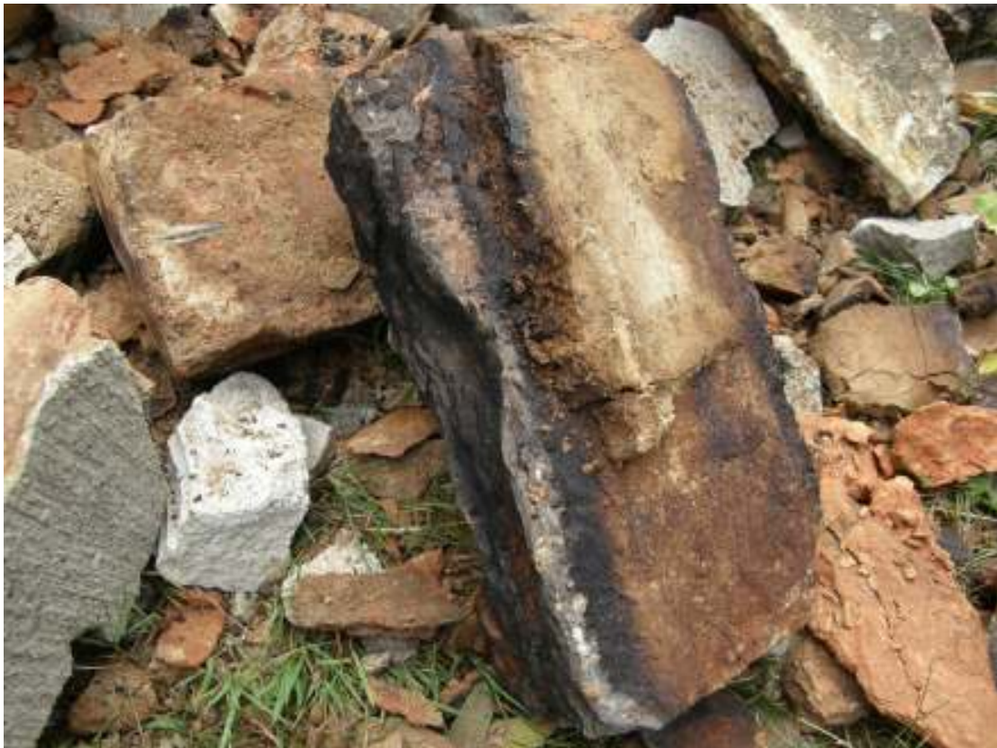
Fig. 12. Lerbruk på sotad tegelsten. Notera sotet på den starkt vittrade lerfogen, vilket vittnar om att skorstenen invändigt var i tämligen dåligt skick innan insatsrören monterades.
