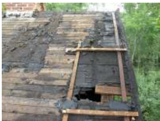
Fig. 8. Skada vid västra partiet.
