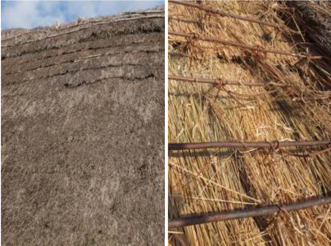
Portalängans tak före (t.v.) omläggningen, oktober 2013. Rafterna var synliga i de övre varven och nästan alla dockor i ryggingen hade ramlat ner. T.h. ses de gamla vidjorna och halmen som var lagd som ströläkt.
