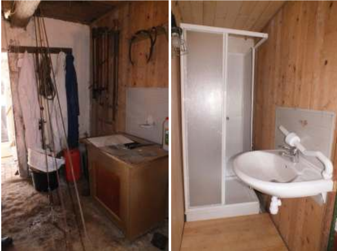
En duschkabin installerades med nya innerväggar i verkstaden. Där det funnits en bo placerades ett tvättställ.
