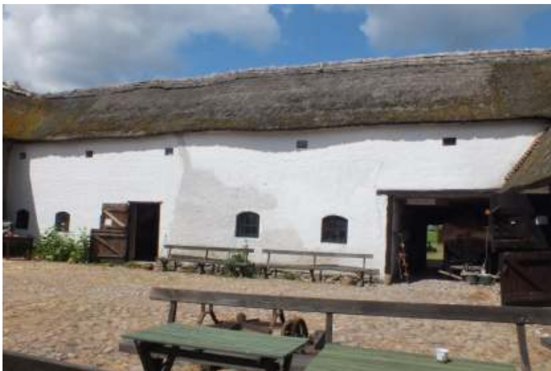
Portalängans södra fasad mot gården anvärdades med kalkfärg. Fjölårets lagning syntes tydligt medan väggen var fuktig.
