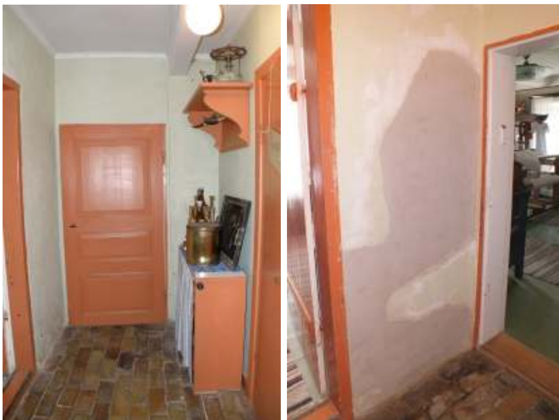
Hallen mellan det yttre köket och vävstugan i tvåvåningslängan med vävstugans dörr i fonden och Oves rum till vänster. T.v. ses så som hallen såg ut 2008 med skador på nedre delarna av väggarna och sprickor bredvid dörren. Under årets arbeten lagades alla puts-skador i rummet, inklusive väggen mot Oves rum (t.h).
