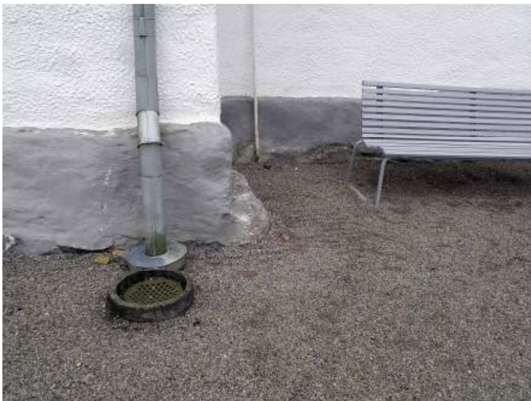
Kyrkans och tornets norra sida. En hög, putsad och grämälad sockel med ojämn ovankant finns utmed kyrkans fasader.
