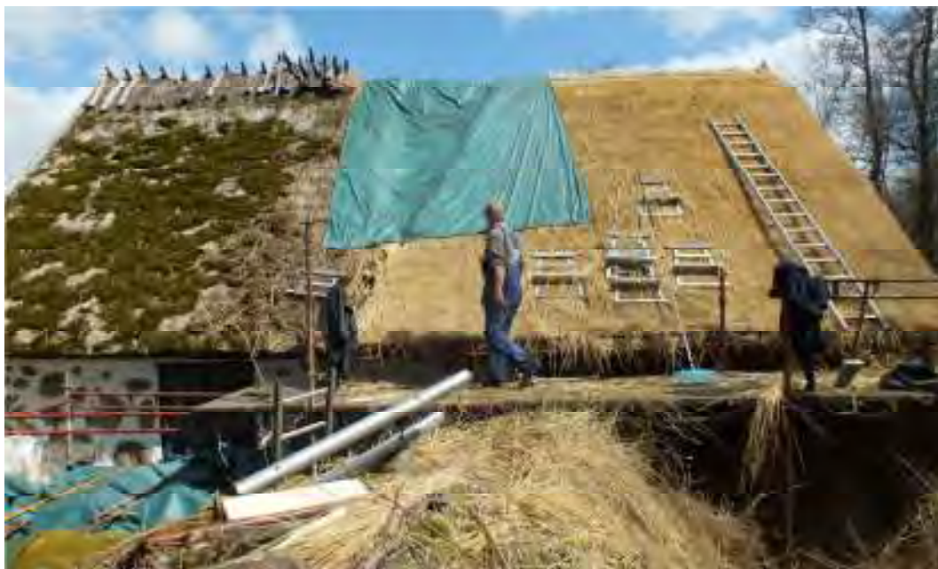
Takfallet åt söder var kraftigt mossbevuxet och stråttäckningen var mycket tunn.
