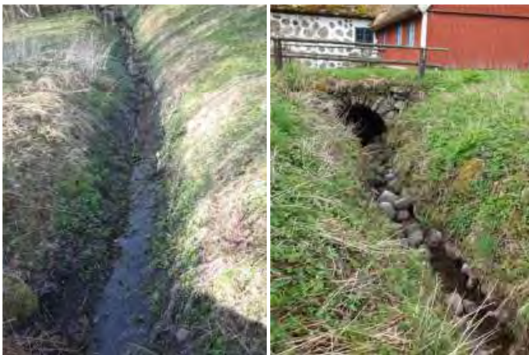
Bilderna visar kvarnrännans skick innan åtgärderna genomfördes. På den vänstra bilden syns sträckan uppströms kvarnbyggnaden och på den högra bilden syns den del som ligger nedströms. Fotografiet till vänster är taget av Kenneth Olsson, Albo härads hembygdsförening.
