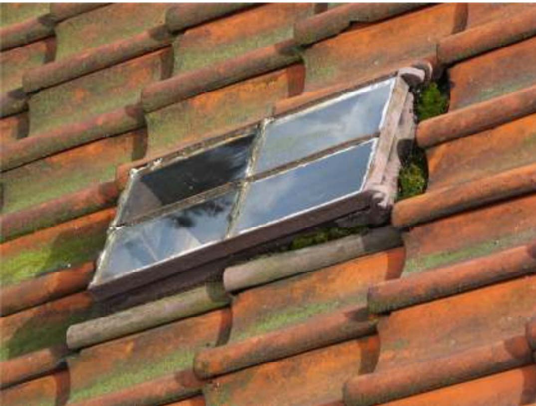
Kyrkan hade ett flertal söndriga fönster, t ex var takfönstret i behov av att kittas om.
