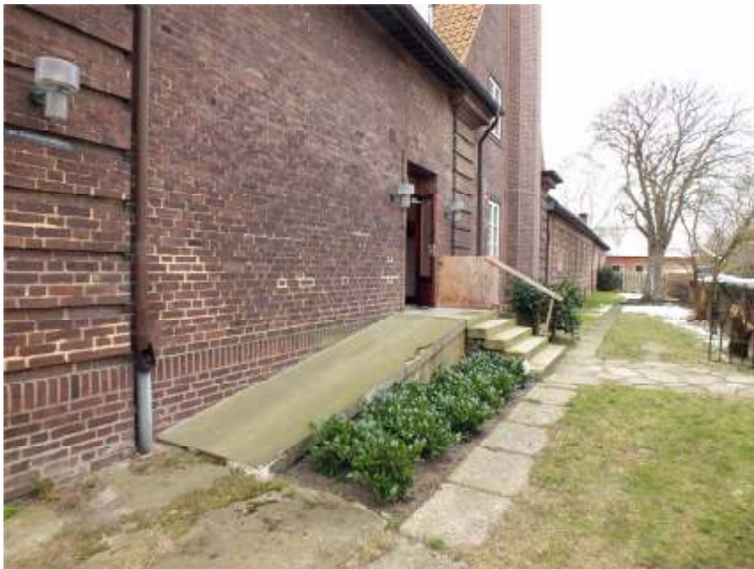
Norra entrén med bristfällig ramp och nedmonterade räcken i januari 2014 före åtgärderna utfördes.
