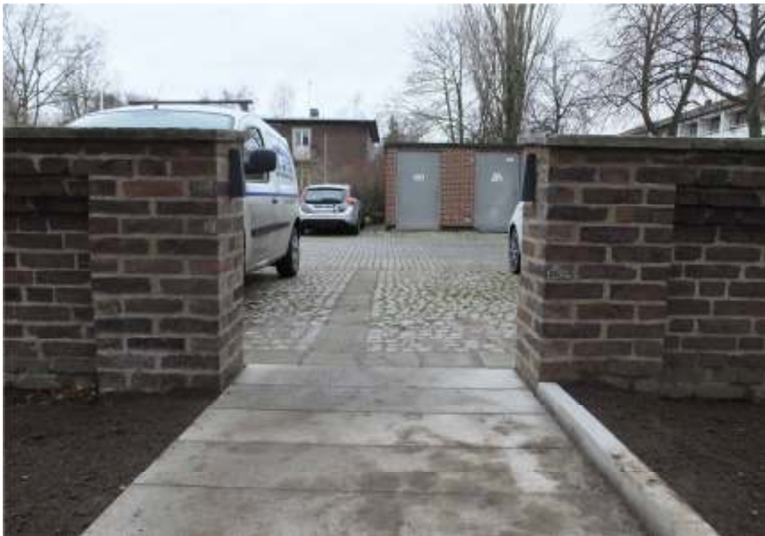
En ny öppning i norra muren togs upp för att få en bättre förbindelse mellan parkeringen och kyrkobyggnadens ingångar på norra respektive västra sidan. Murstolpen till höger i bild utgjorde tidigare en pilaster i muren. Stolpen
