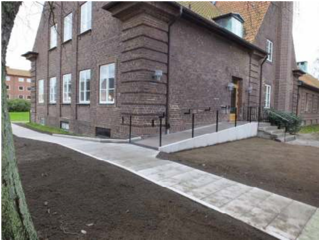
Den nyanlagda rampen med tillgänglighetsanpassad plattgång vid slutbesiktningen i december 2014. Markytorna kommer att förses med gräsmatta.
