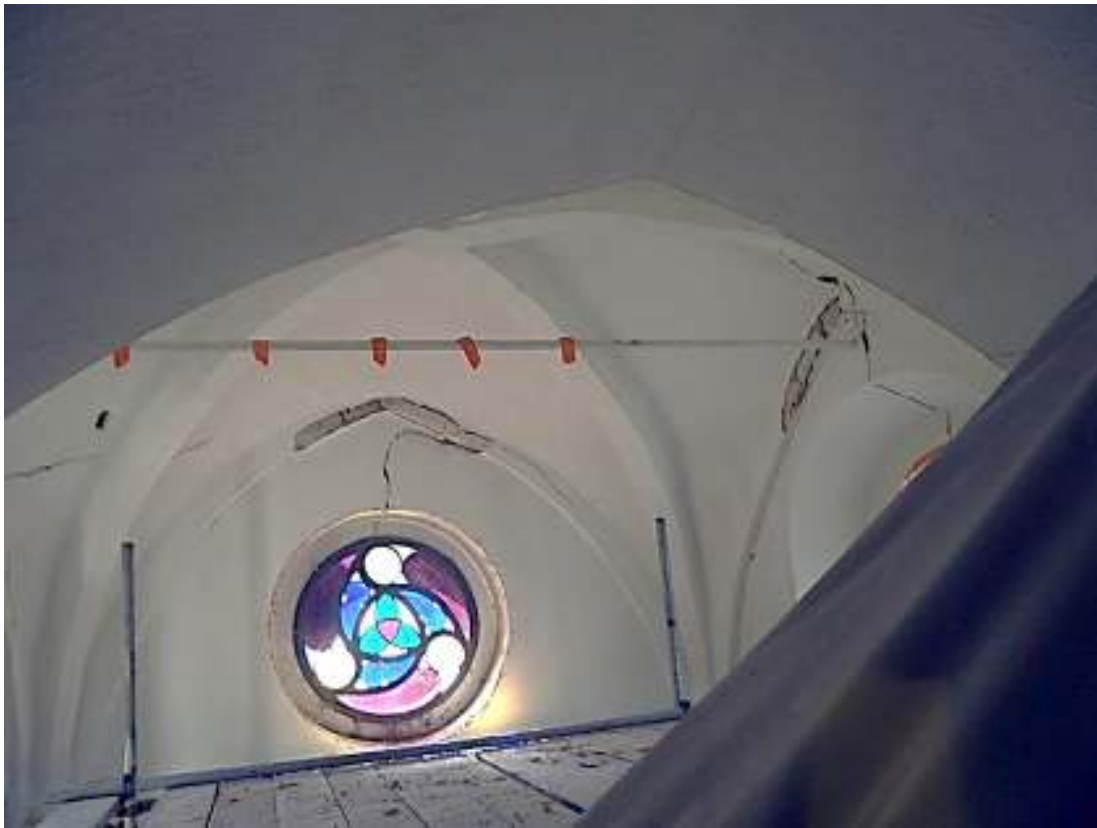
En del sprickor syntes också i sakristians östra och södra valv och mur.
