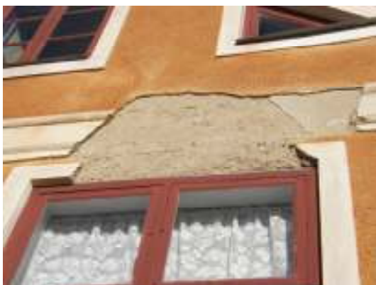
Skadan ovan fönstret.
