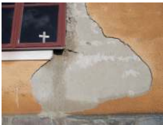
Den större skadan innan arbetet.
