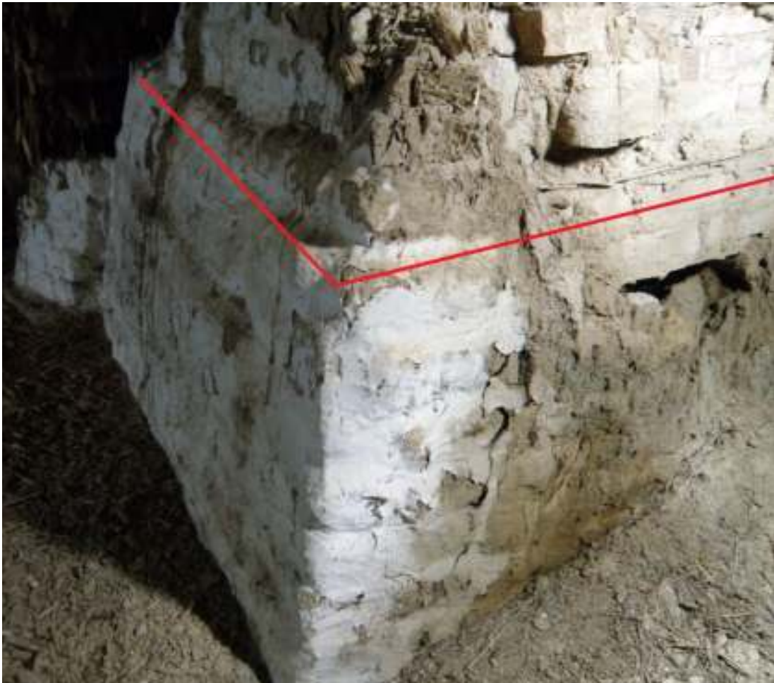
Gränsen för nedmonteringen markerad. Större delen av materialet ovanför markeringen utgjordes av tegelsten och cementhaltigt murbruk.
