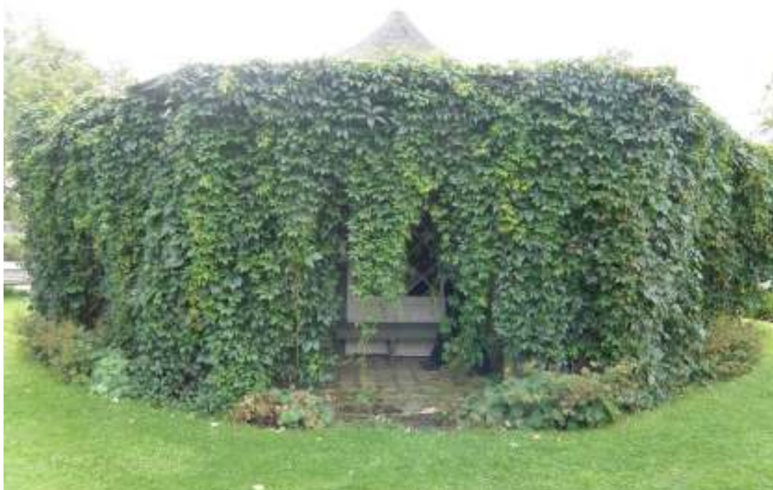
Vegetationen kring paviljongen har bundit mycket fukt till konstruktionen, vilket troligtvis är en av anledningarna – förutom bristfälligt underhåll mm – till den stora skadebilden.
