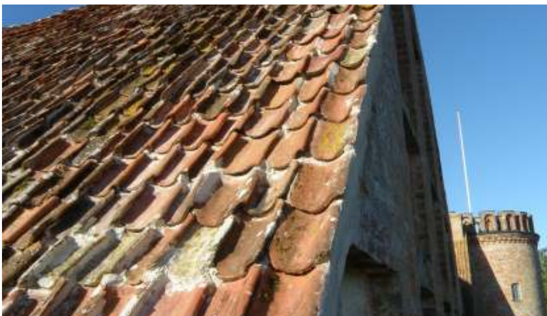
Ex. på pannornas dåliga passform. Notera de ”vridna” pannorna.
