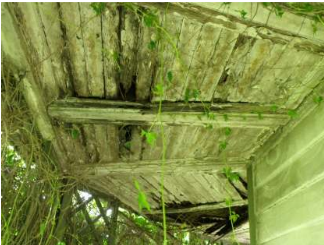
Del av skadebilden innan arbetet.
