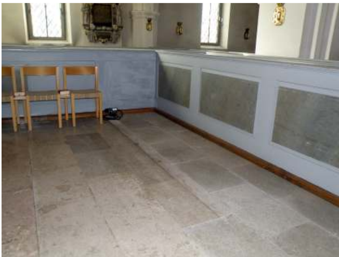
Södra bänkkvarterets främre del. Vid slutbesiktning var ommålningen av södra bänkfronten fortfarande flammig och behövde målas om ytterligare en gång.
