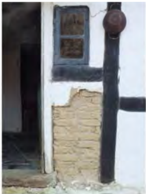
Den blottade lerstenen före åtgärd.
