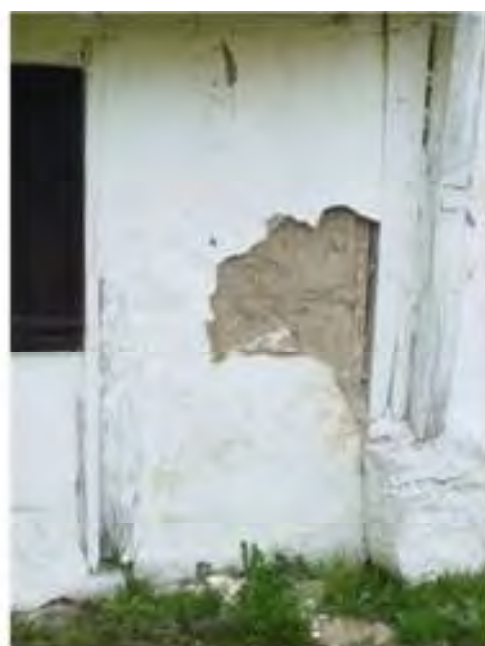
Smygen där bruket lossnat före lagning.
