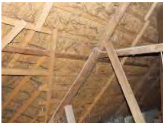
Sparrtaks konstruktion med stöttad rötskadad sparr.
