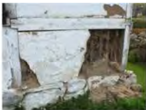
Västra fasaden, hörnet mot söder före lagning..
