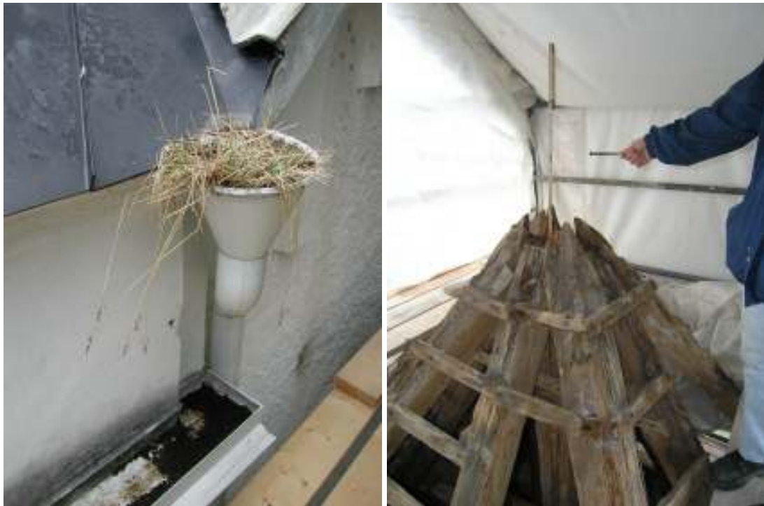
Kyrkans avvattningsystem var i stort behov av rensning. Till vänster syns en av stuprörstrattarna. Till höger syns taklagets topp med rötskadade sparrar. Markering vid tumstocken anger den rötskadade spirstockens ursprungliga längd.
