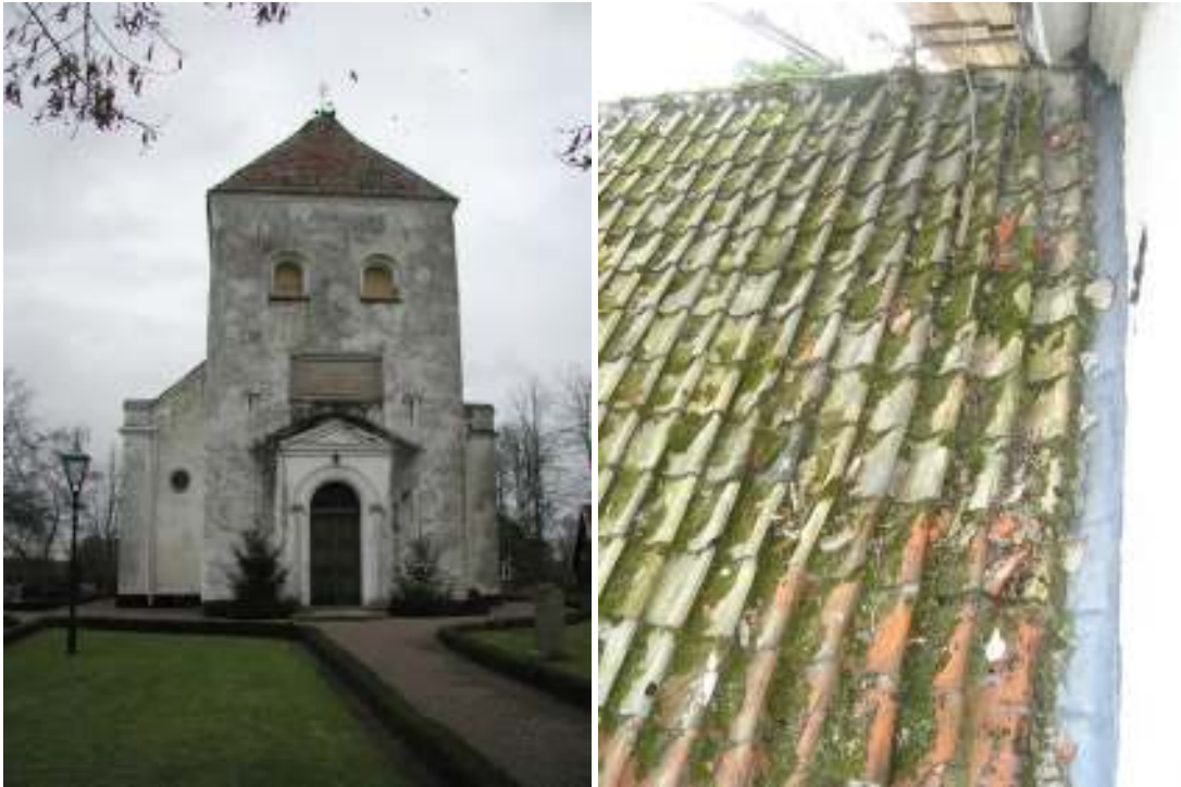
Till vänster: Fasaderna var kraftigt missfärgade av alger. Till höger: Yttertaket var mossbeläpset och i stort behov av rengöring.
