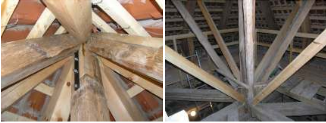
Till vänster syns torntaklagets topp efter renovering. Då den övre delen av tornets yttertak inte kan understrykas erhöjll den en yttre kåpa av bly. På bilden till höger syns torntaklagets nedre del med nya sneidsträvor fogade mellan sparrar och mittstolpen. Sneidsträvorna tillkom som extra förstärkning av stammen.
