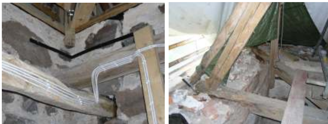
Till vänster: Vid tornets sydvästra hörn förstärktes muren med ett järnband. Under järnbandet syns den rötskadade dragbjälken. Bilden till höger visar rötskadade bjälkar/knutpunkter vid murkrönet.
