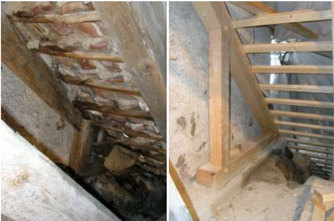
Bilden till vänster visar skadad takstol över långhuset intill tornets östra gavel. På bilden till höger syns takstolen efter renovering med nytt virke.
