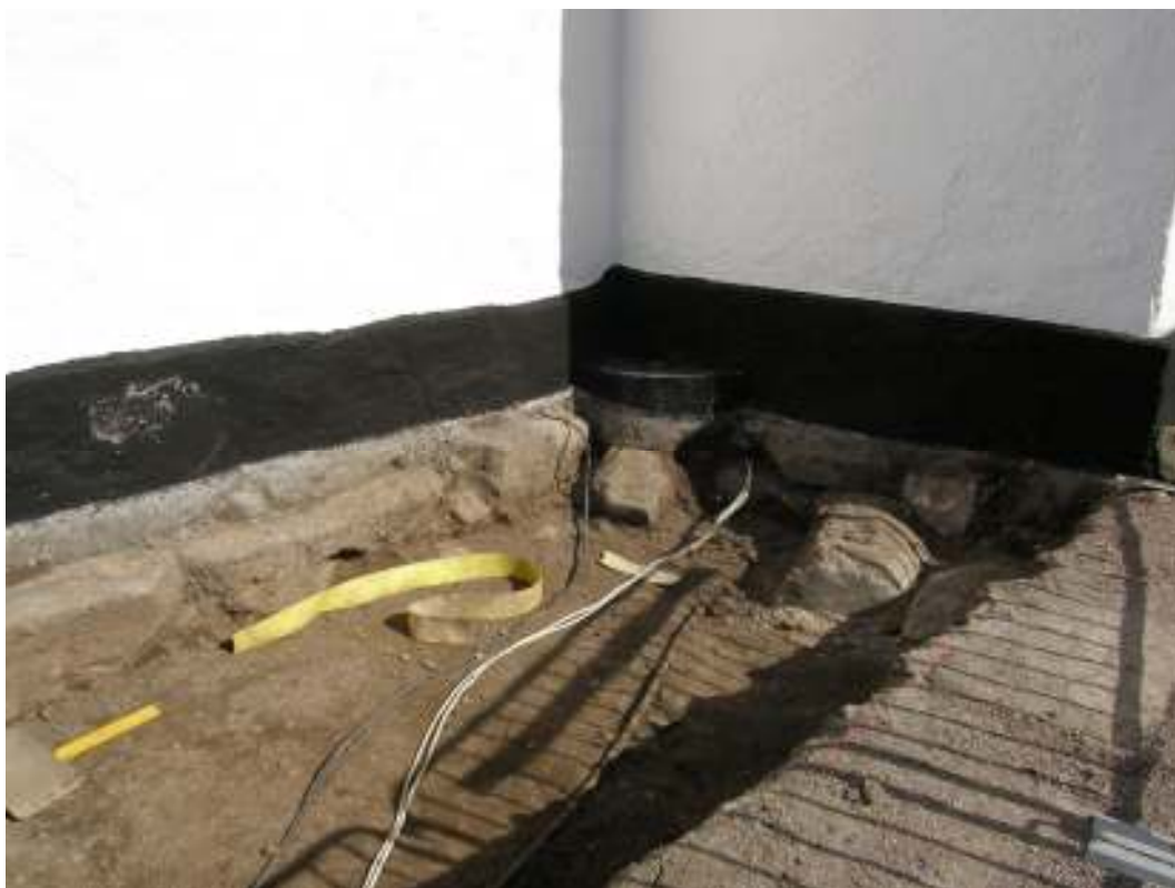
Södra sidan av tornet efter utgrävning. Notera skiftet i grundstenarnas nivåer intill hörnet, södra fasaden.
