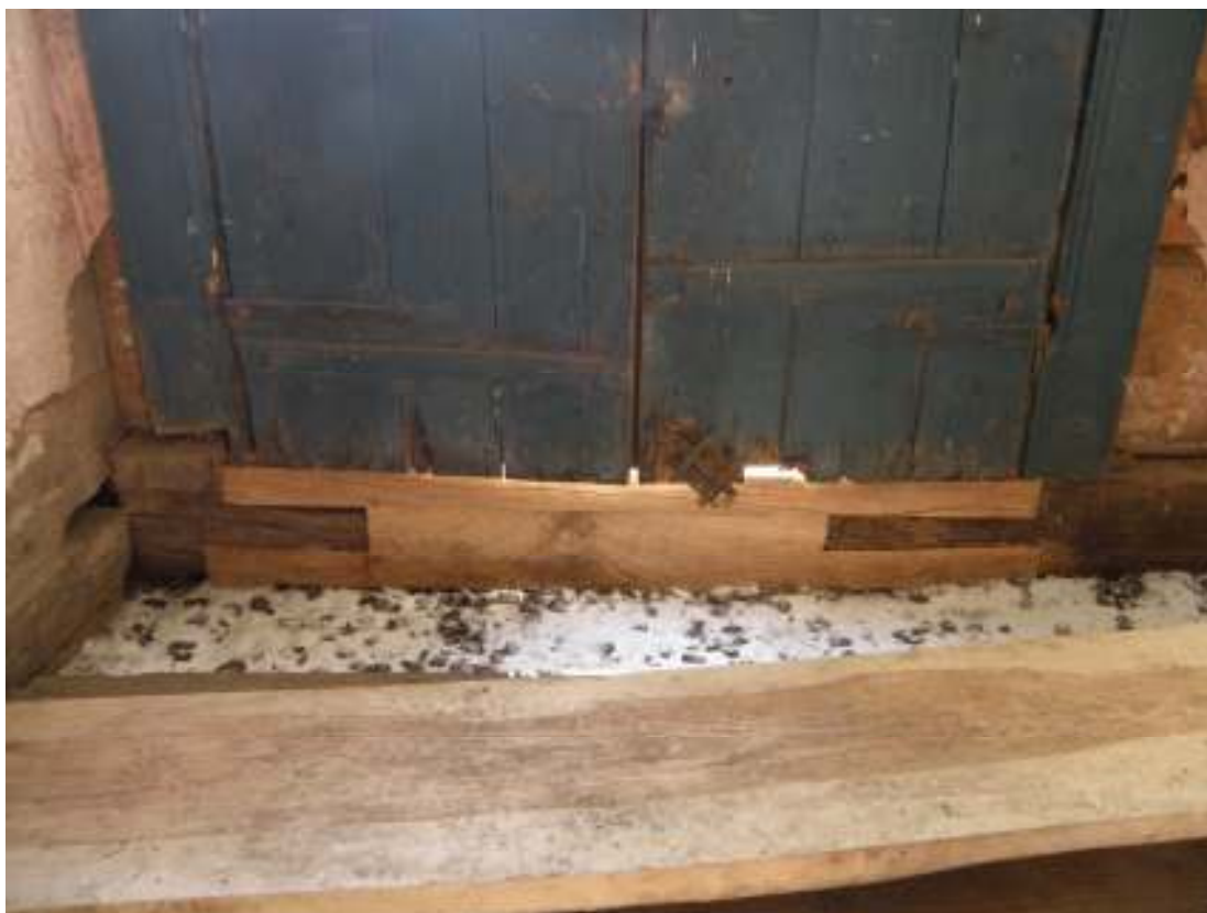
Fig. 11. Saltningen. Notera den handbyvlade golvbrädan.
