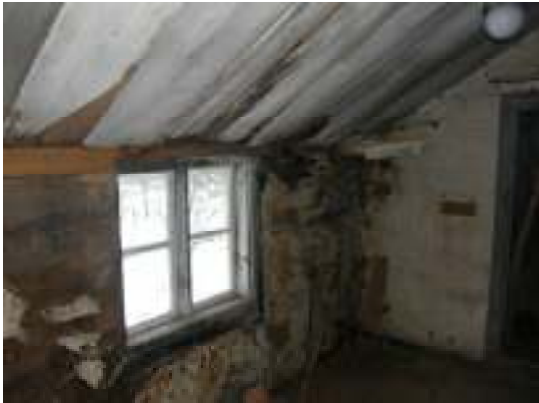
Fig. 8. Rum 22, innan borttagning av takbrädor.
