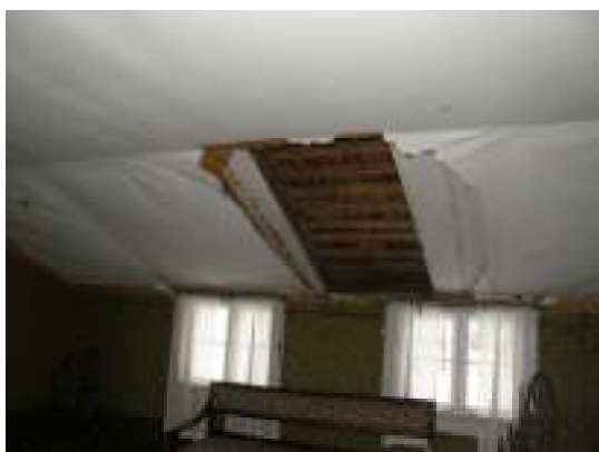
Fig. 6. Rum 20. Saknade takbrädor.
