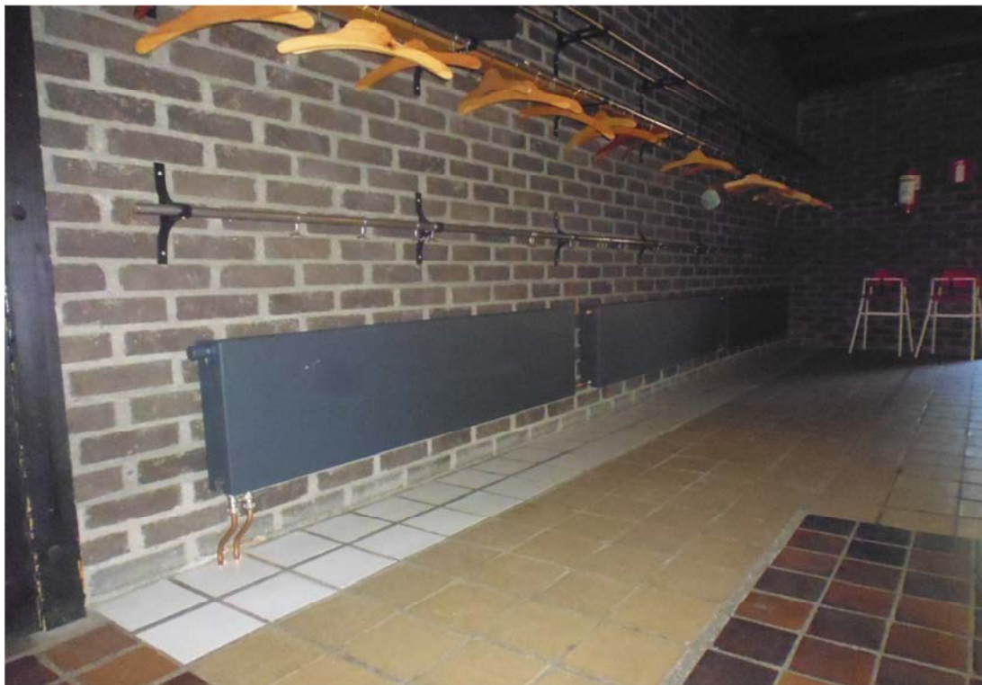
Konvektorradiatorerna med plåtbeklädnad (vid samlings salens entrédel).
