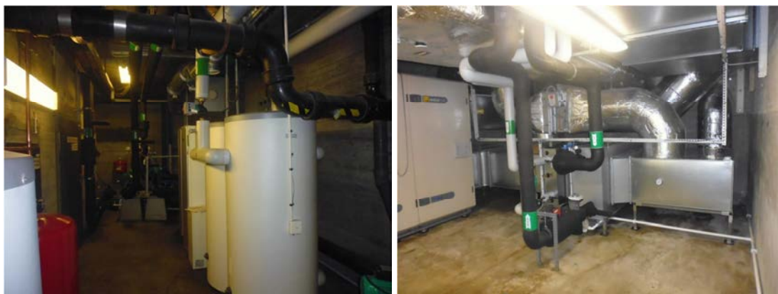
Värmepumparna (t.v.) och ventilationscentralen (t.h.).
