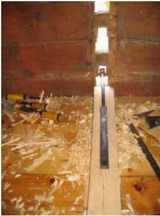
Bild 8 Nerfälld golvbjälke med nerfällt järn som ska hålla samman längsidorna.
