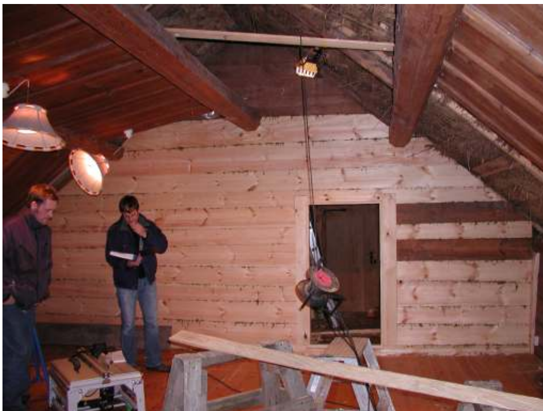
Färdig vägg, till höger syns de återanvända sparrarna som timrats in i väggen.
