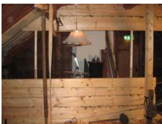
Bild 13 Väggen timras nu nerifrån och upp. Notera de smala följarna som ger väggen rätt lutning.
