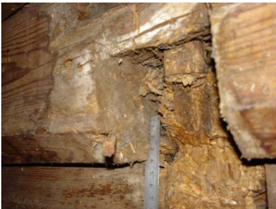
Bild 7 Överträets lönning synlig i den borttagna knutkedjan.
