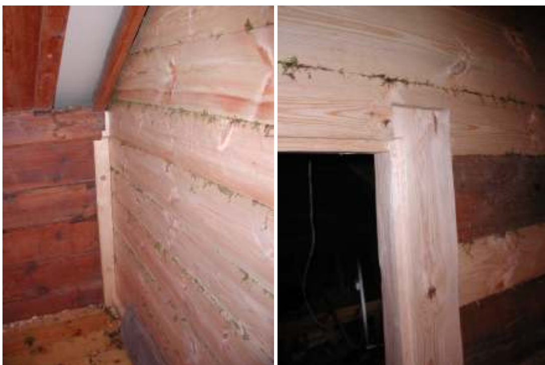
Glipan mellan äldre knutkedja och nytimrad vägg täcks av lister som fästs med dymlingar. Till höger syns gåt i söder, notera glipan för att tillåta sjunkning.
