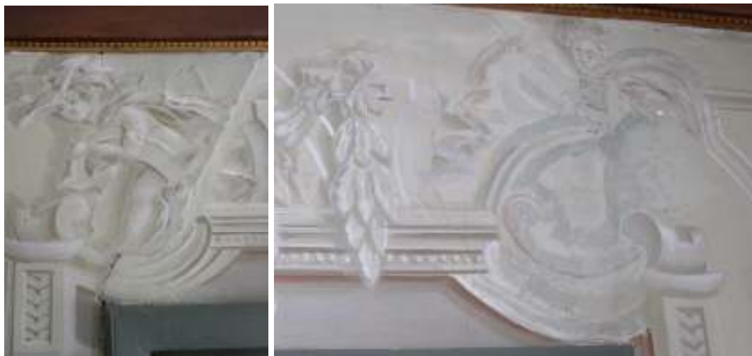
T.v. Sättningskada i partiet ovan den västra dörröppningen i salen. T.h. Äldre retusch utförd i mörkare oljefärg än den ursprungliga målningen.
