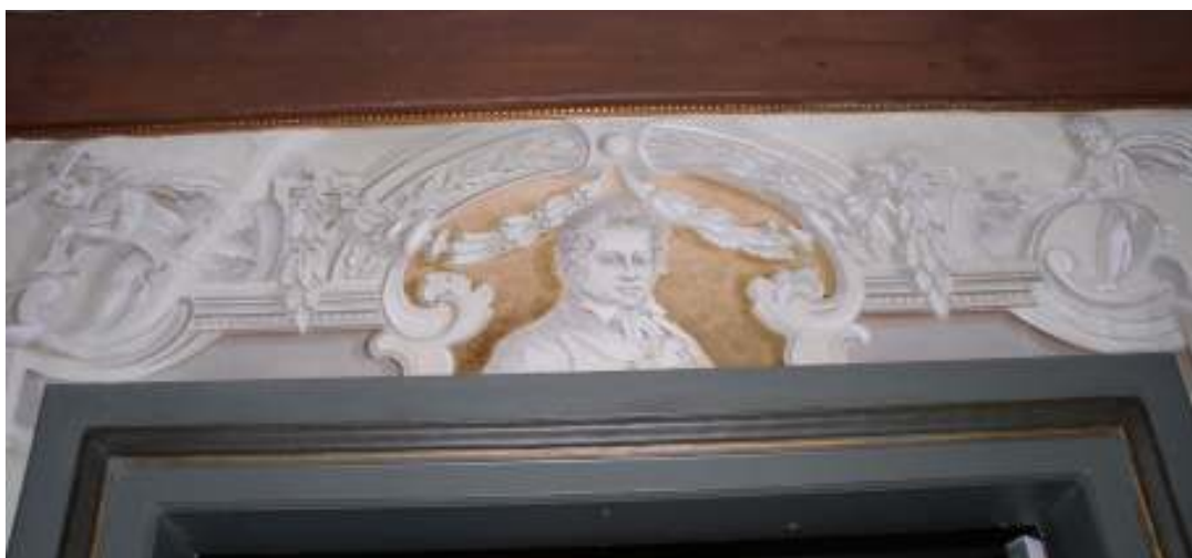
Parti av frisen, ovan den västra dörröppningen, efter åtgärd. Sprickan har lagats och den äldre retuschen har bättrats och ljusats upp för att komma närmre det ursprungliga utförandet.
