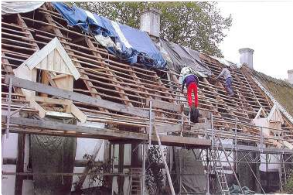
2002-års arbeten med takkupor och takomläggning på församlingshemmets västra sida. Foto: Gunnar Arvidsson, A-konsult. Takcupornas bärande delar itappades i samstämmighet med ursprungligt utförande.
