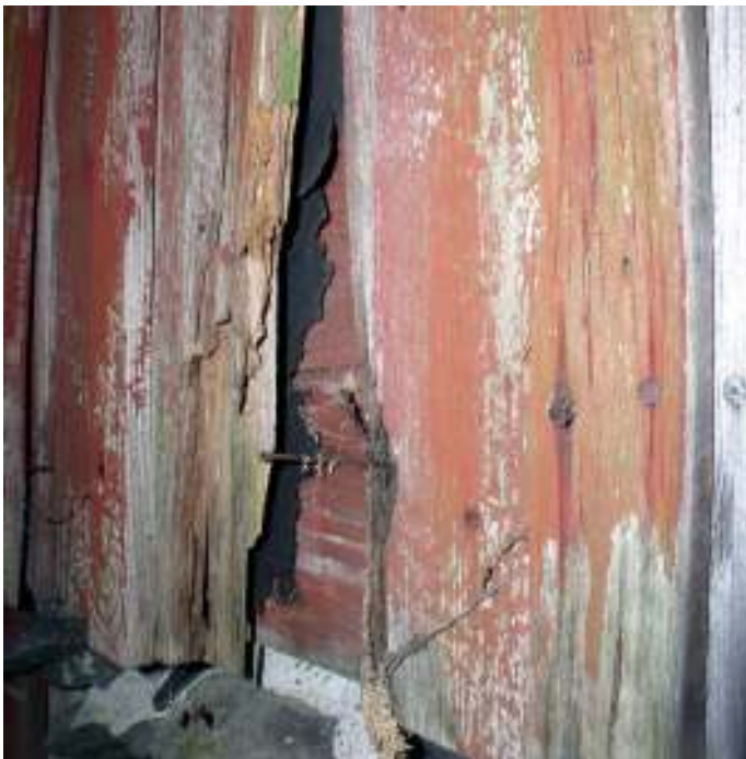
Detalj av byggnadens bältekonstruktion, som också varit rödfärgad. Skymtar fram under rötskadad locklistpanel.
