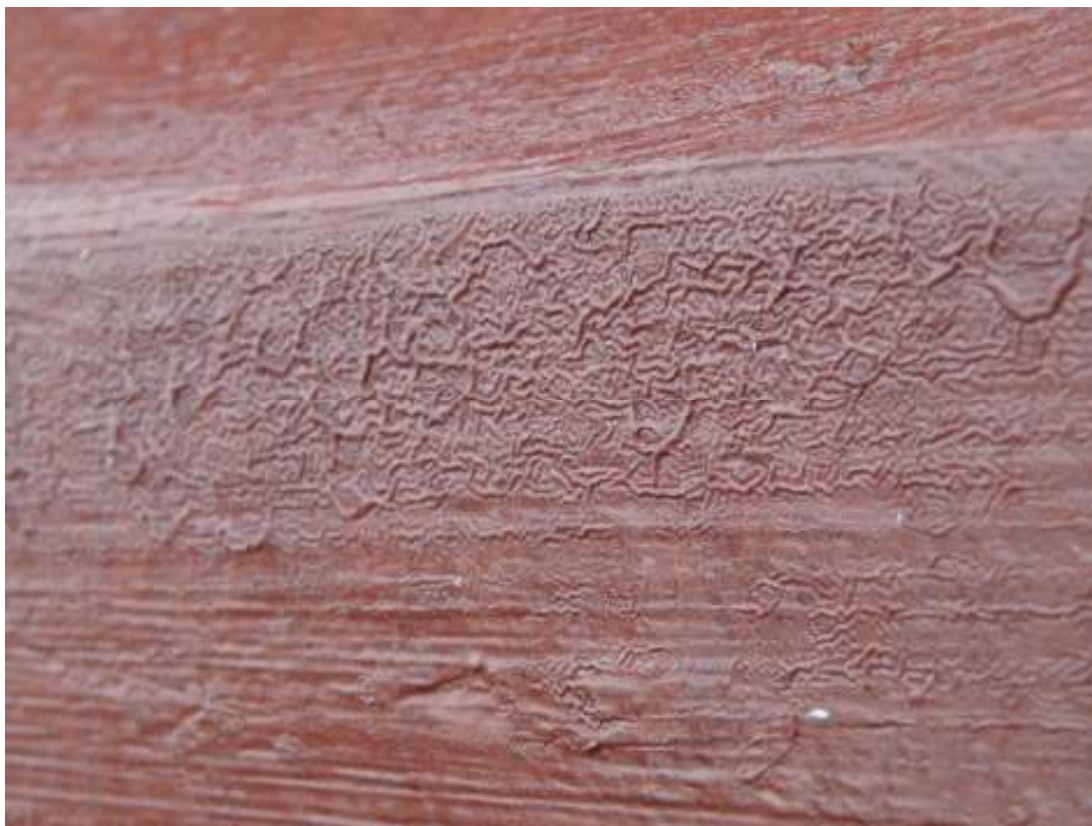
Bild 2: Närbild på rynkig färg.
