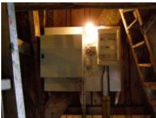
El-centralen på V väggen.
