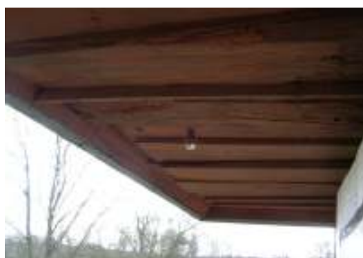
Sprinklerdysa under taksfoten.
