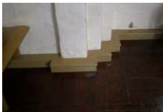
Kabelkanal, mot trägolvet.
