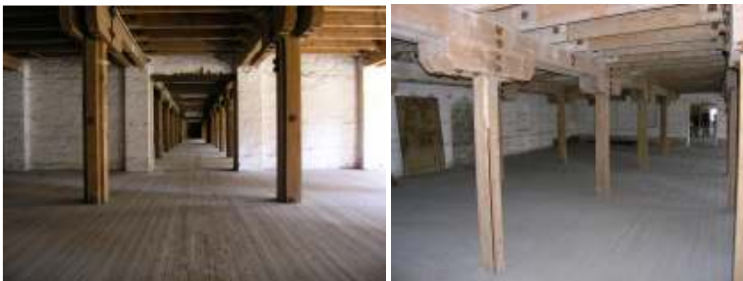
Konstruktionen i magasinets mittersta delar består av virke som bultats samman. Golven är obehandlade brädgolv.
