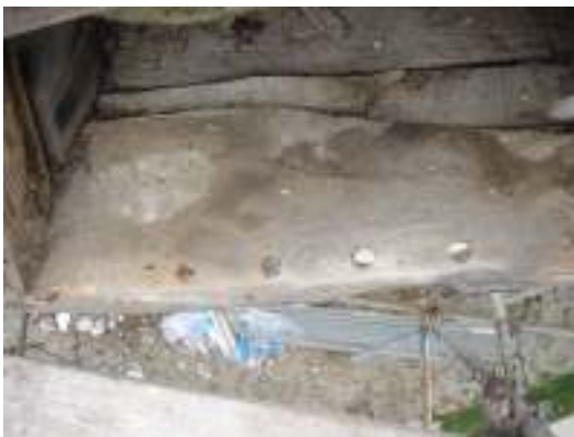
Borrade ventilhål i takfoten.
