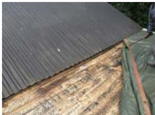
Rötskadan enl. nr 4 på ritningen ovan.
