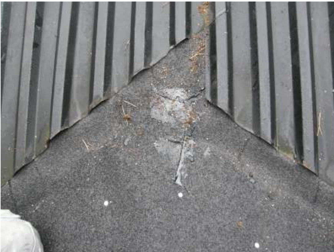
Tätning vid valvtakets – scenutbyggnaden – anslutning mot det branta takfallet.
