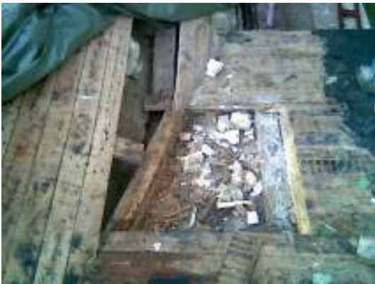
Rester efter insprutad isolering.
