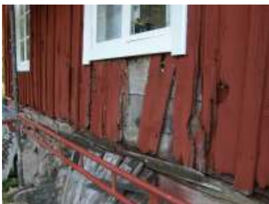
Den förstörda panelen, innan arbetet.
