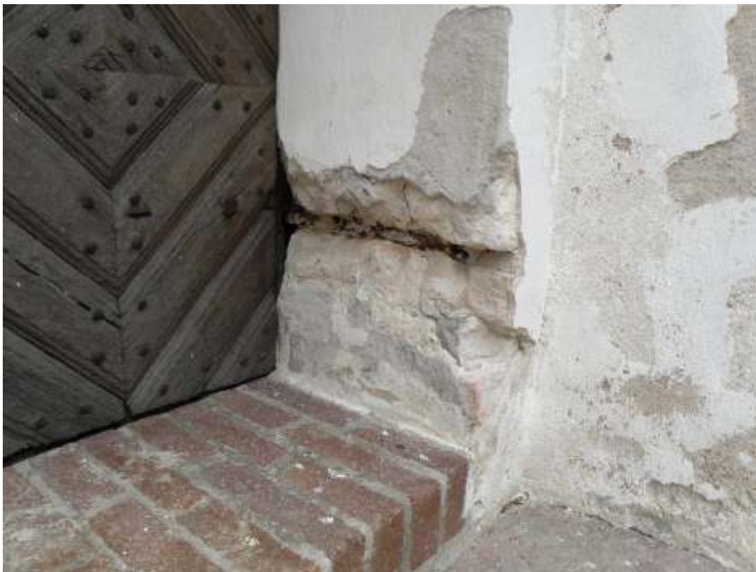
Bild 18: Rostskadade hängslen på västporten vid friläggning.
