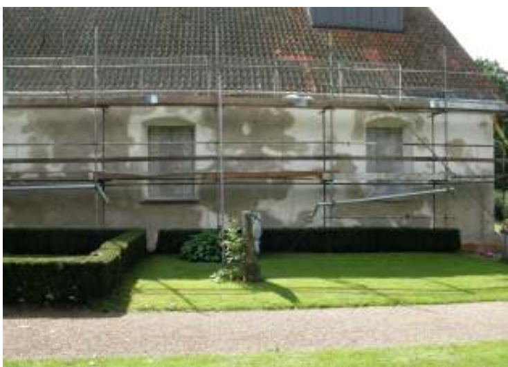
Bild 7: Omfattning av putsläggningar på långhusets norra fasad
