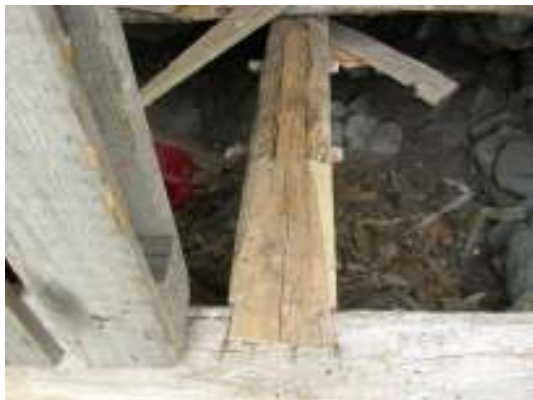
Skarvad bindbjälke, ilaxad i syllen.
