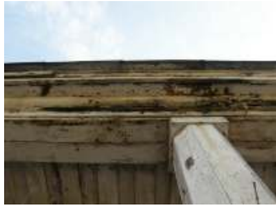
Rötskadad lejd vid balkongens entréparti.
