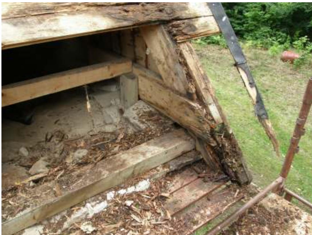
Rötskadad sparre vid nordvästra hörnet.
