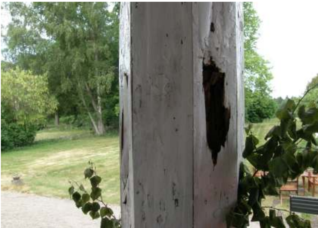
Pelare med kraftigt rötskadad beklädnad.
