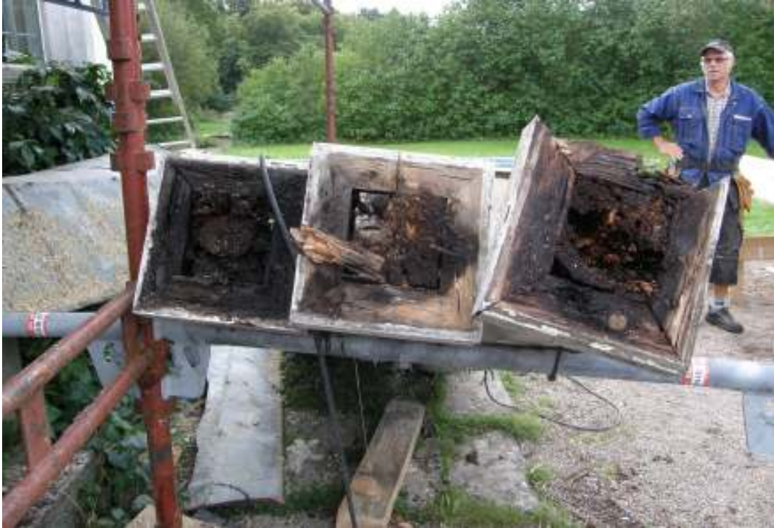
Tre av de fyra pelarna befanns vara av röta förbrukade, dvs både kärnorna och beklädnaderna.
