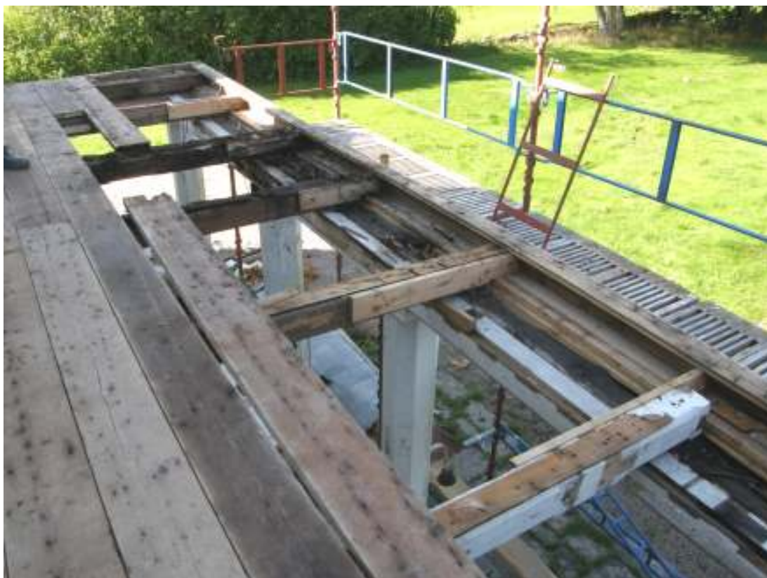
Tidigare utbytta bjälkar å balkongen. Notera den rötskadade lejden. Den hitre ljusblå bjälken är en återanvänd, anfasad verandastolpe (okänt var den ursprungligen suttit).
