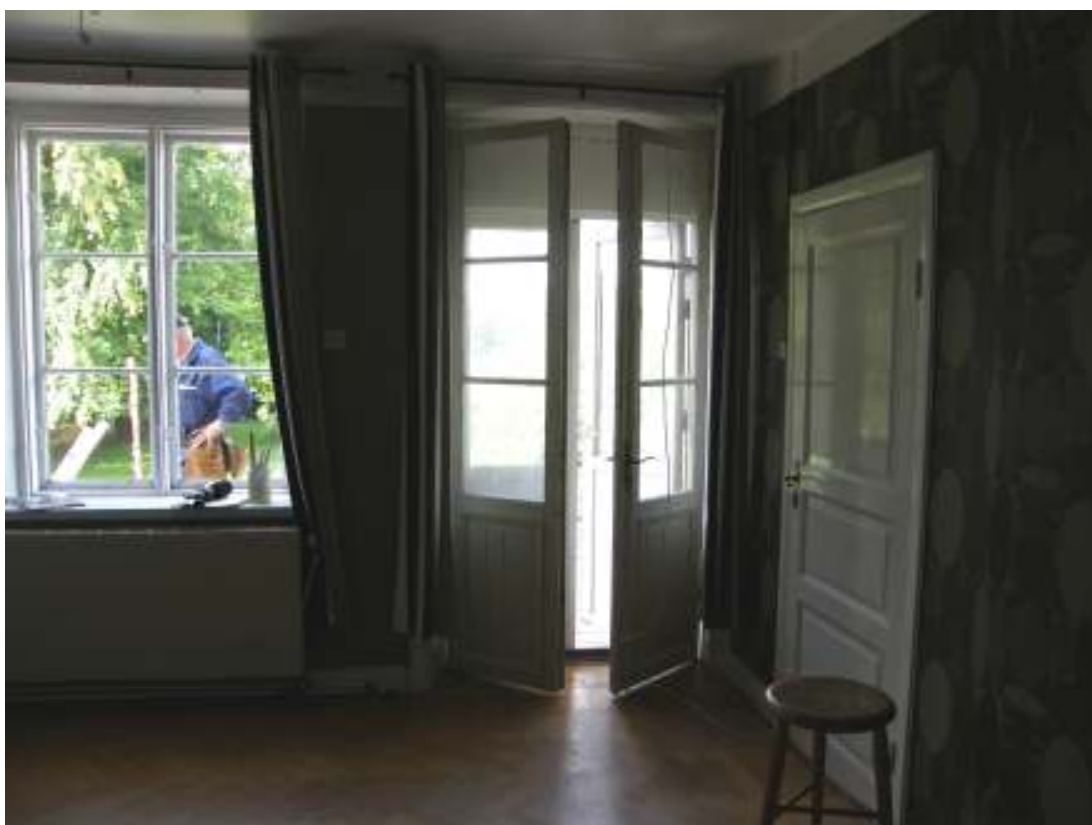
Frontespisens invändiga dörrblad monterade på originalkarmen, i kvarvarande gamla gångjärn. Dessvärre är funktionen satt ur bruk pga den sentida insatta altandörren, som monterats inuti originalkarmen.
