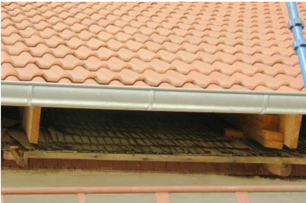
Detalj av hur takfoten påverkats av påbyggnad av tak. Dessutom syns de nya, tvåkupiga Nibra-pannorna i närbild.
