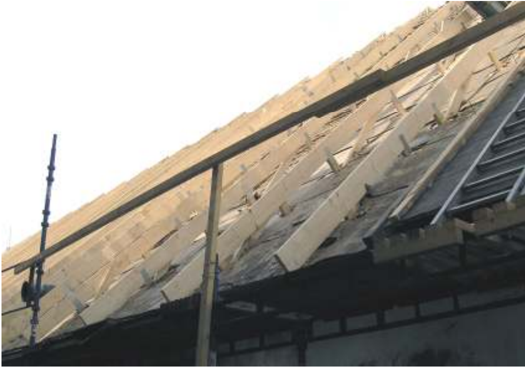
Byggnadens mittparti har med åren sackat rejält, varför den nya takstolen byggde på ganska mycket här.
