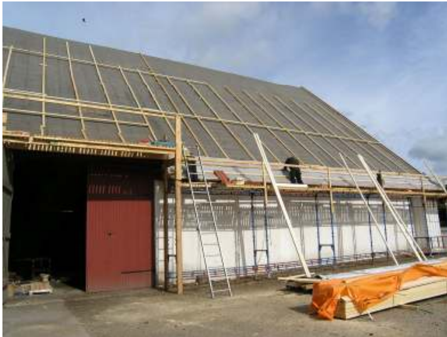
Tak och takstol över byggnadens norra del härrör från 1970-talet. Skadorna var här begränsade till rutten läkt.
