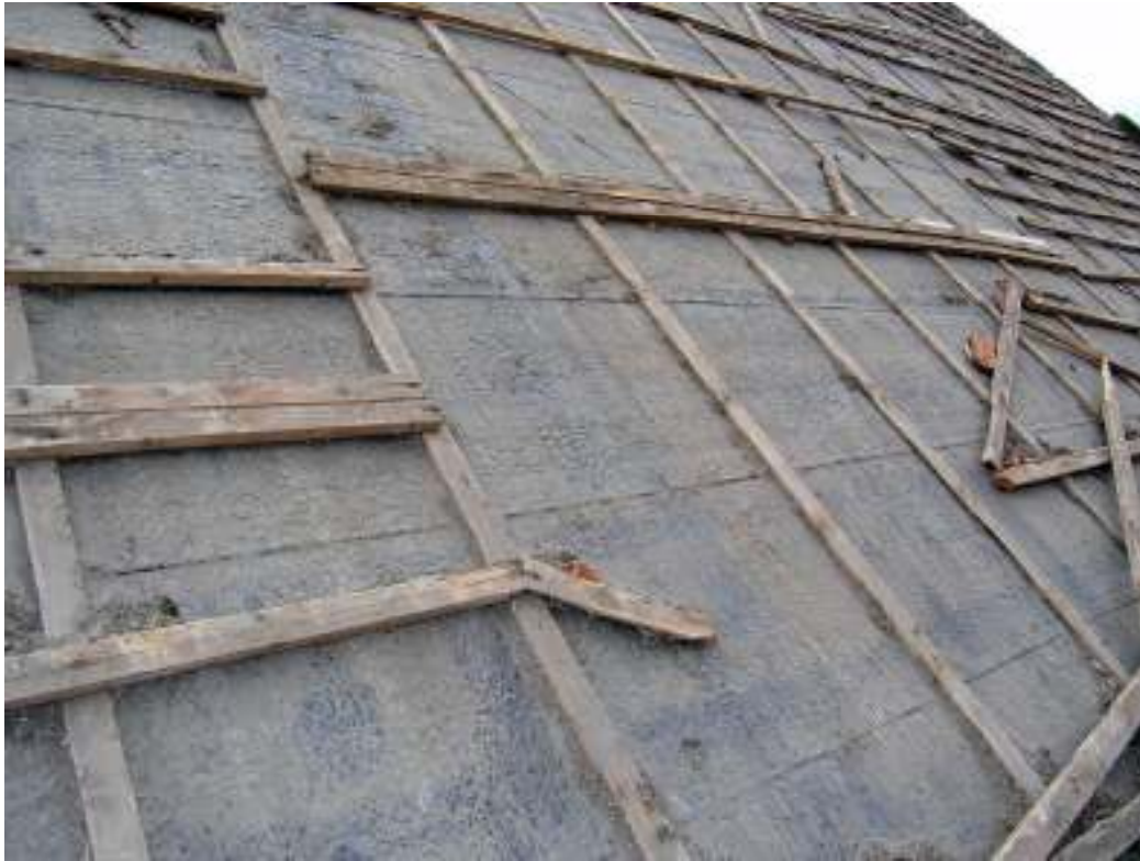
Taket över byggnadens södra del, rester av det gamla porttornet, var tidigare täckt med tjärat papptak, horisontella våder.
