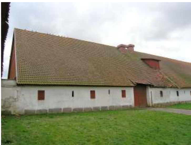
Fasad åt väster, norra delen, före takarbetena. De två ventilationsbuvorna togs bort i samband med takomläggningen.
