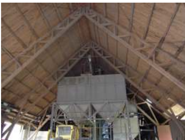
I norr utgörs takstolen av modern fackverkskonstruktion. Här syns också torkanläggningen, som sattes in i mitten av 1990-talet.
