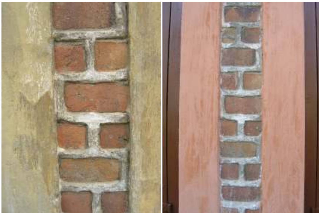
Omfattningen tv var lagad med cementhaltigt bruk.
