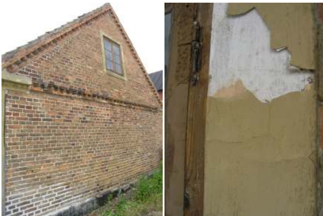
Östra gaveln med profogning längst ner till vänster i bild. Detalj av färgtrappa på kalkavfärgad omfattning vid fönster.
