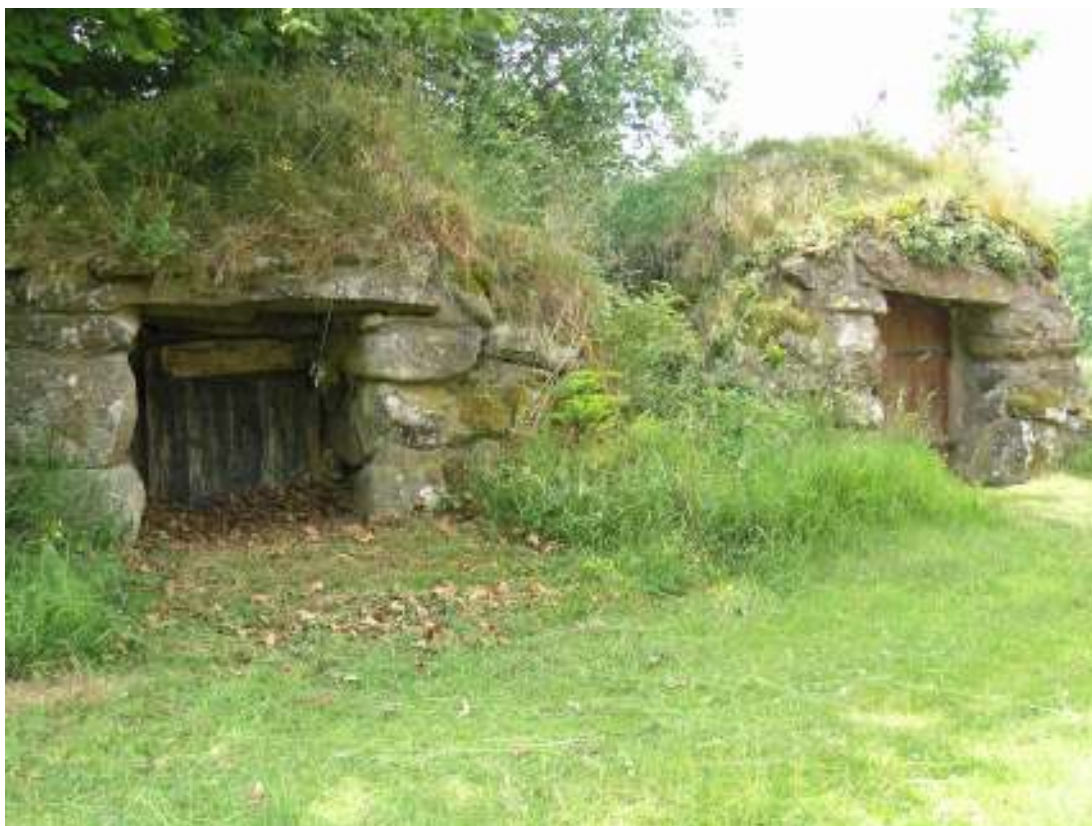
Täckarehusets jordkällare för åtgärd.
