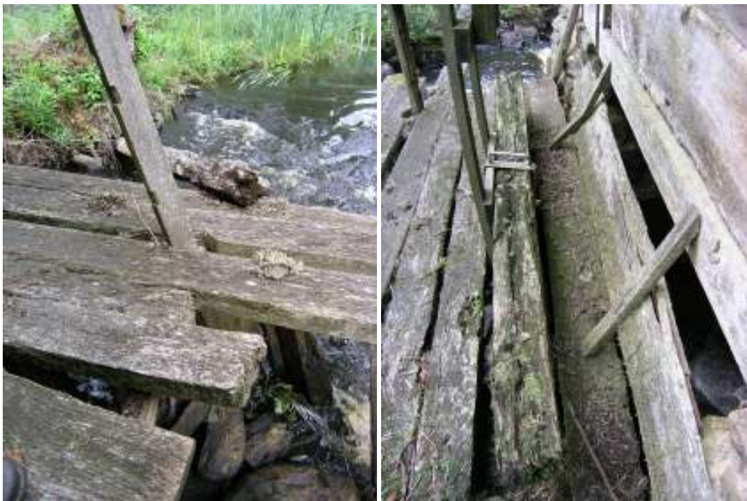
Den tidigare gångbrygga, vilken var på väg att ge sig.
