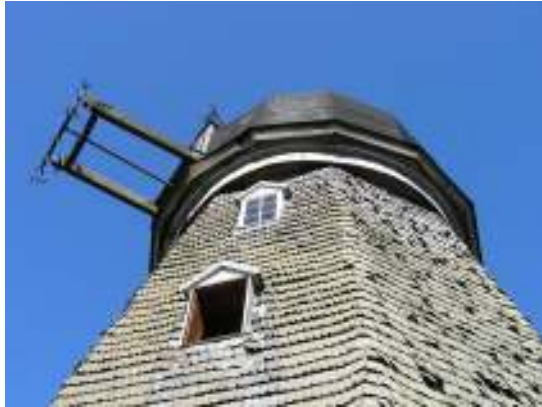
Bölets takspån är i behov av byte.
