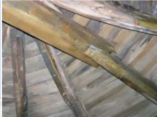
Hättans råspont uppvisar flera rötskador.
