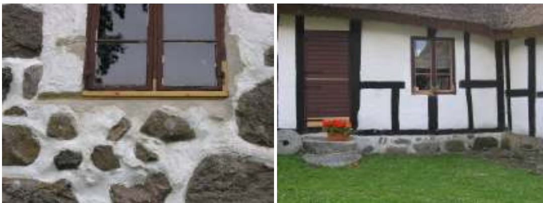
Notera bräder under fönstrets karmbottenstycke (1).
