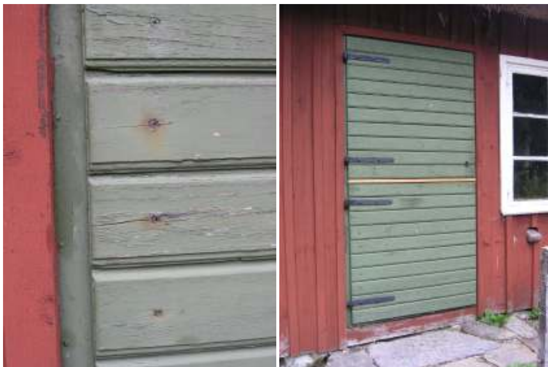
Södra längans södra dörr med skruvar som rostar (2).
