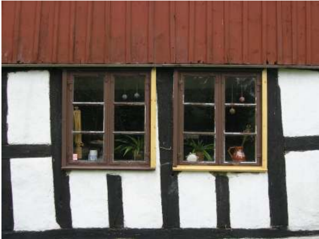
Fönster på boningsdelens, södra längans, östra gavel i samband med slutbesiktningen (11 och 12).
