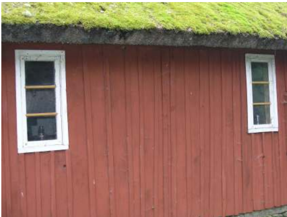
Svinhusets fönster efter att de kraftigt rötskadade spröjsarna hade ersatt med nya av friskt virke (1 och 2).
