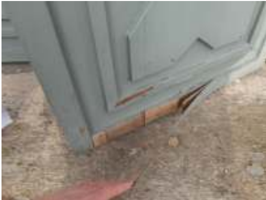
Absidens ytterdörr, skadad dekoration.
