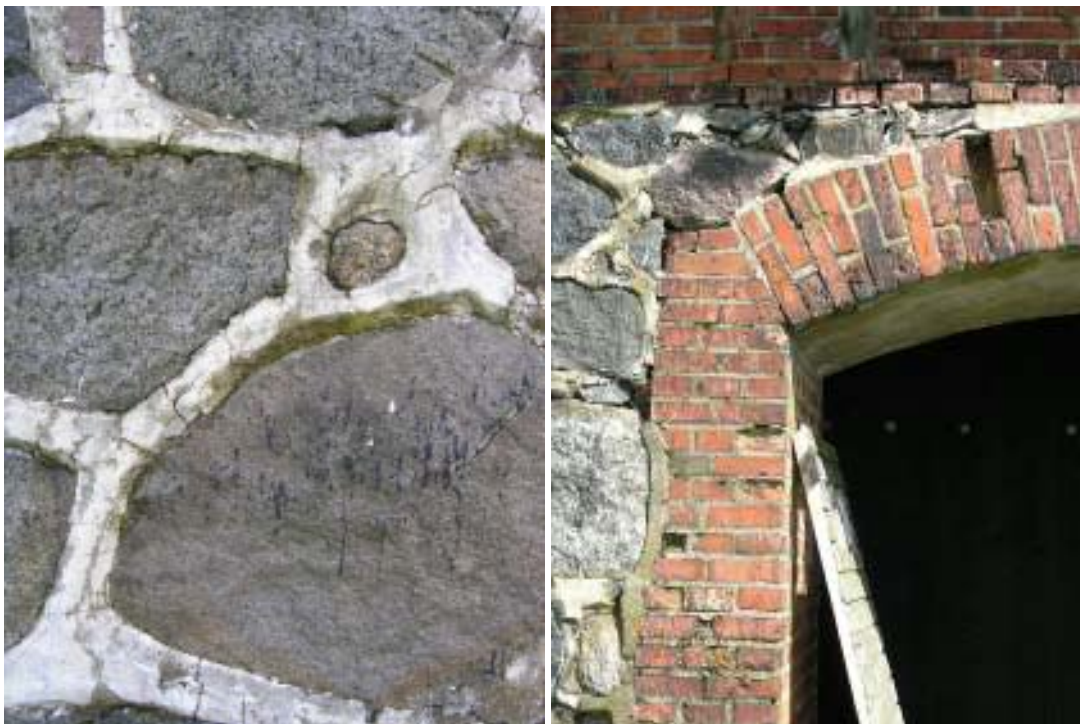
Detalj av naturstenens cementfogar.
