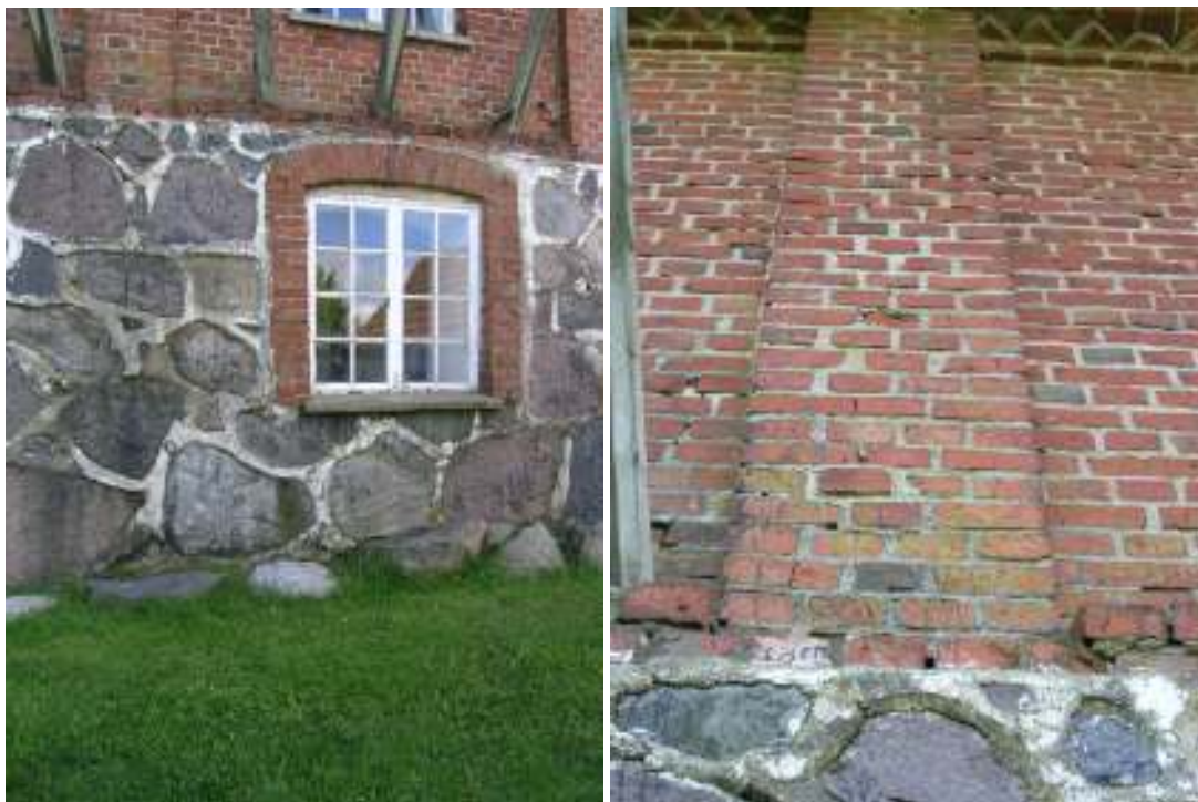
Portloftets natursten fogad med cementbruk som spricker. Förlagsloftets murverk i tegel har fogar som vittrar och faller ut.
