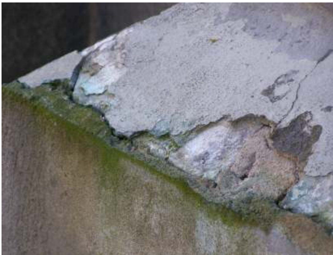
Bild 2 överst t.v: Västportalen före arbetenas utförande med puts-skador i smygens nedre delar samt algbevuxen puts. Bild 3 överst t.h: Puts-skada i mittpost på fönster på långhusets södra sida. Bild 4 nederst: Puts-skada på den horisontella delen av korets sockel.
