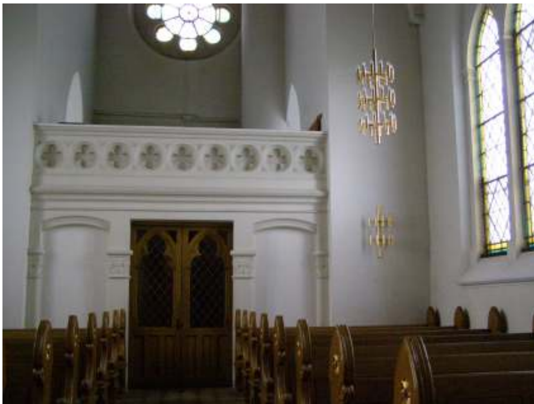
Bild 12: Torninteriör sedd från öster. Observera dragjärnet som ligger synligt mot tornets västra murverk.
