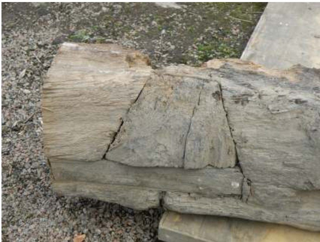
Den gamla syllen från östra längans dörrbål i söder, mot gården. Syllen visar spår efter en laxstjärt där det suttit en bindsyll till den östra väggen. På syllens ovankant syns spåren efter ett igensatt stolpbål.
