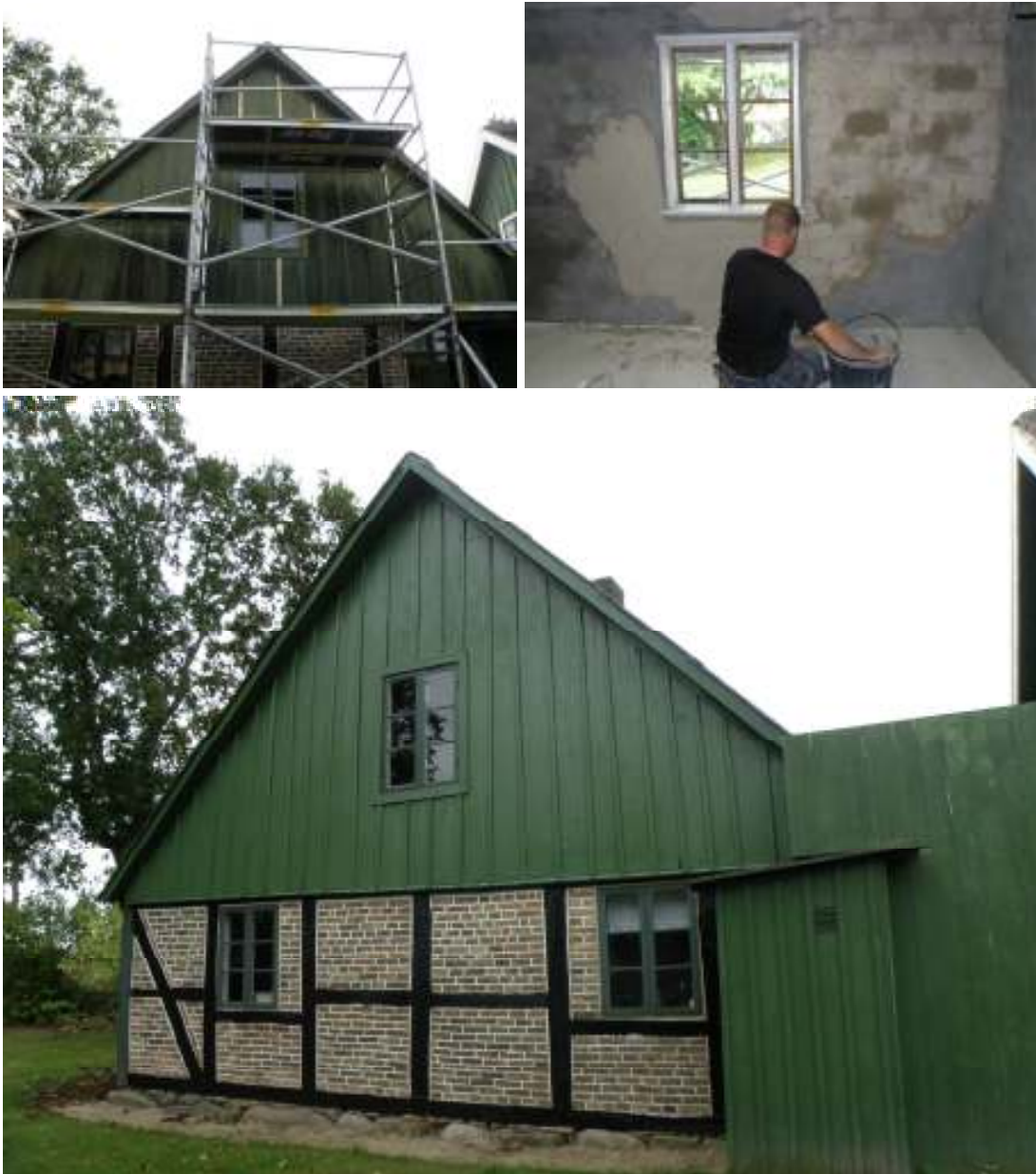
Överst tv: pågående arbete på Brygghusets norra gavelröste. De omkittade och målade fönsterbågarna är på plats, likaså nya ersättningslistor. Th: Kalkanfärgning med kimrök i det tidigare undantaget. Stora bilden: Östra längans norra gavel efter avslutat arbete.
