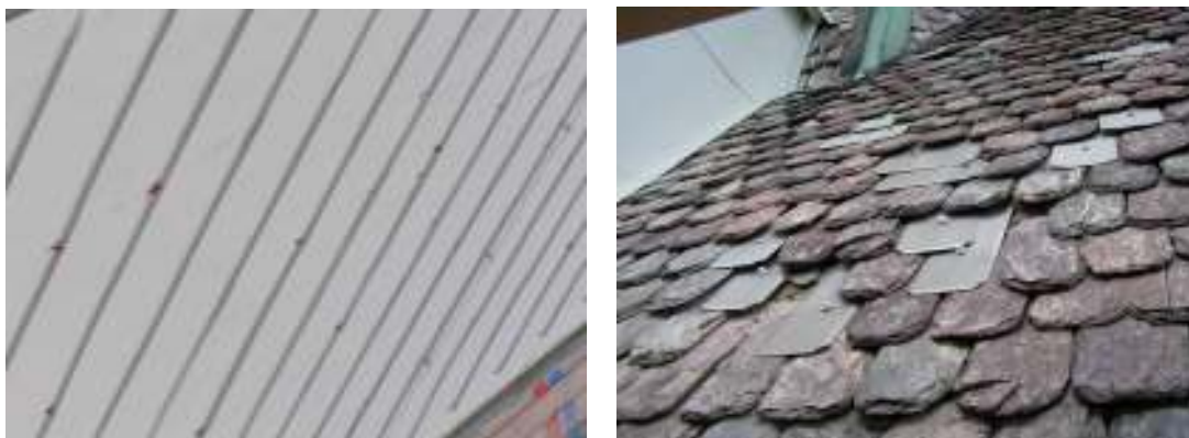
Bild 6 t.v.: Mistor i långhustakets färgskikt efter renföring. Bild 7 t.h.: Äldre lagningar i tornspirans skifferbeklädning utförda med skruvade plattor av rostfritt stål.
