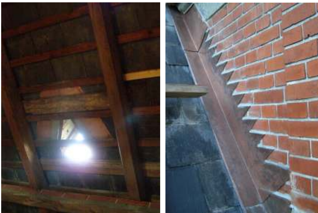
Bild 9: Inskottsplåtar vid en av långhusets nedre takhuvar sedda från undersidan. Bild 10: Nya stånskivor på långhustaket, inskurna i tegelmurverkets fogar.
