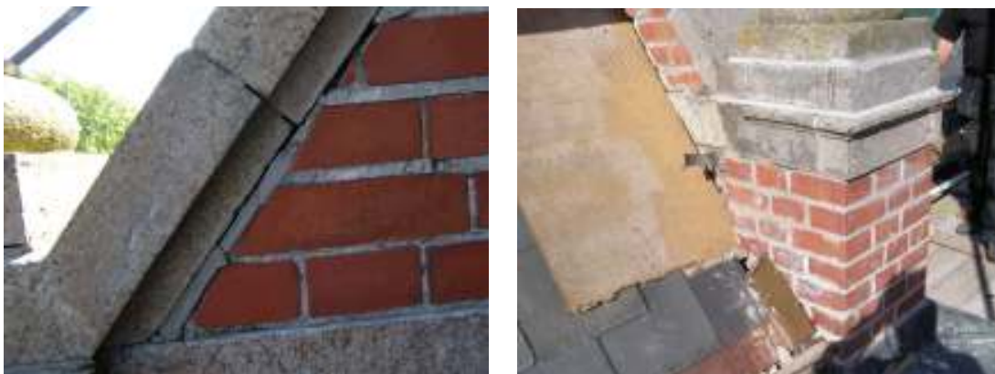
Bild 2: Sprickbildning i fogar p g a sättning i underlag för stenklot i långhusets nordvästra hörn. Tre sådana postament runtom långhuset murades om. Bild 3: Ommurat postament i långhusets sydöstra hörn.
