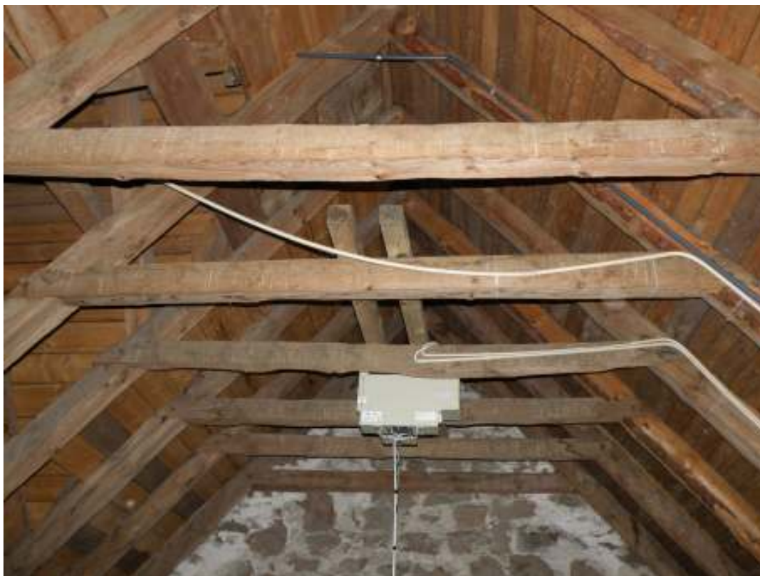
Motorpaketet till den stora ljuskronan närmast koret hänger mitt emellan två bindbjälkar. Infästningarna är gjorda i de två nya träbjälkar som vilar löst på fyra bindbjälkar.
